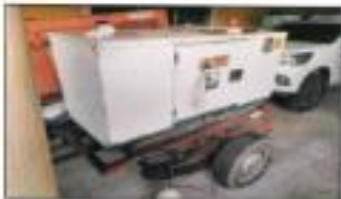
Foto 2: Generador eléctrico oxidado
